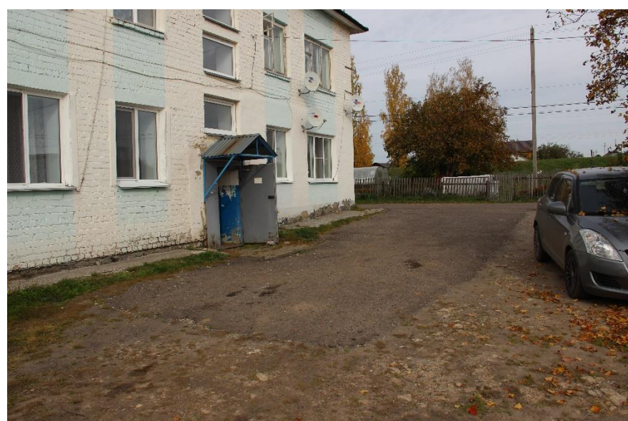
Дефекты асфальтобетонного покрытия проездов
