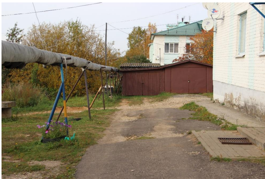
Дефекты асфальтобетонного покрытия проездов
