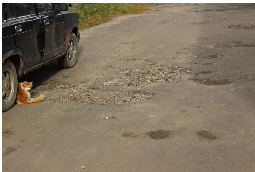
Дефекты асфальтобетонного покрытия проездов
