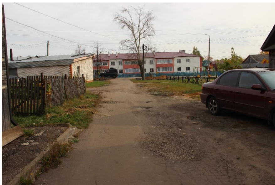
Дефекты асфальтобетонного покрытия проездов
